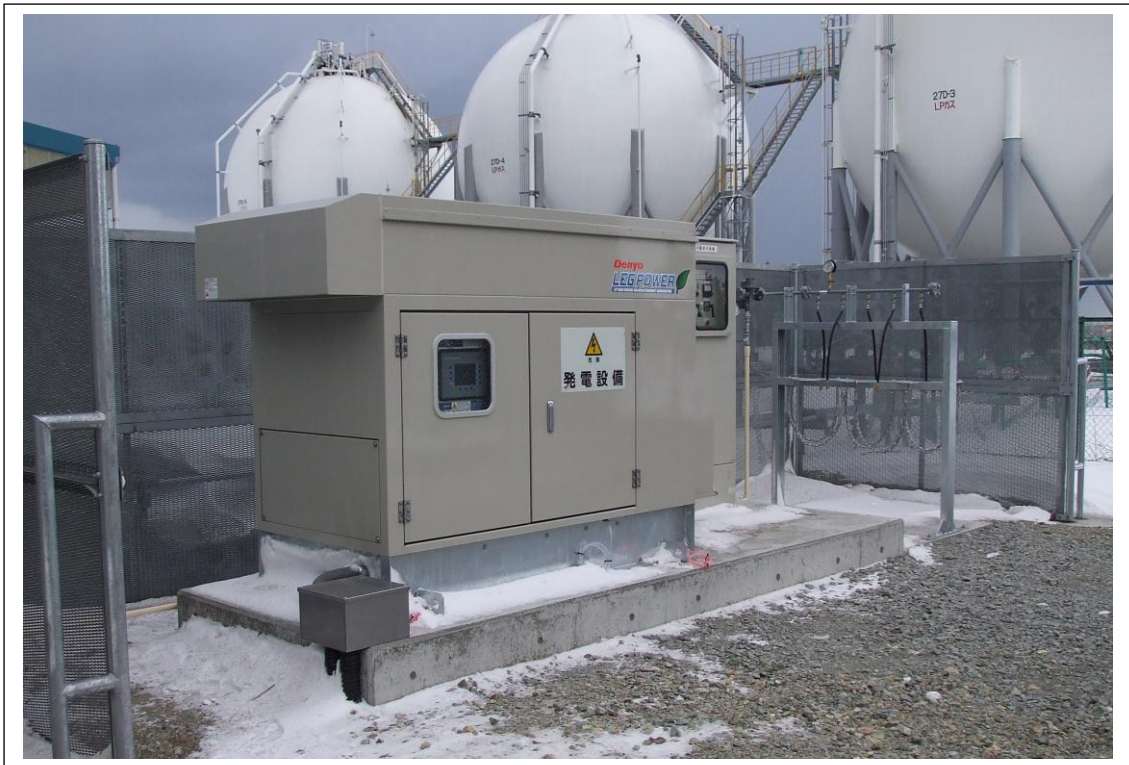
<秋田ガスターミナル内 設置概況>
