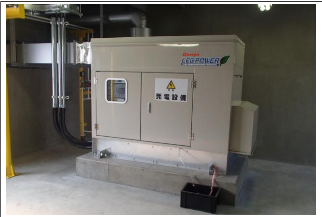
<石狩ガスターミナル内 設置概況>
