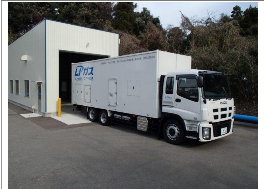
<移動式電源車外観 その1>
