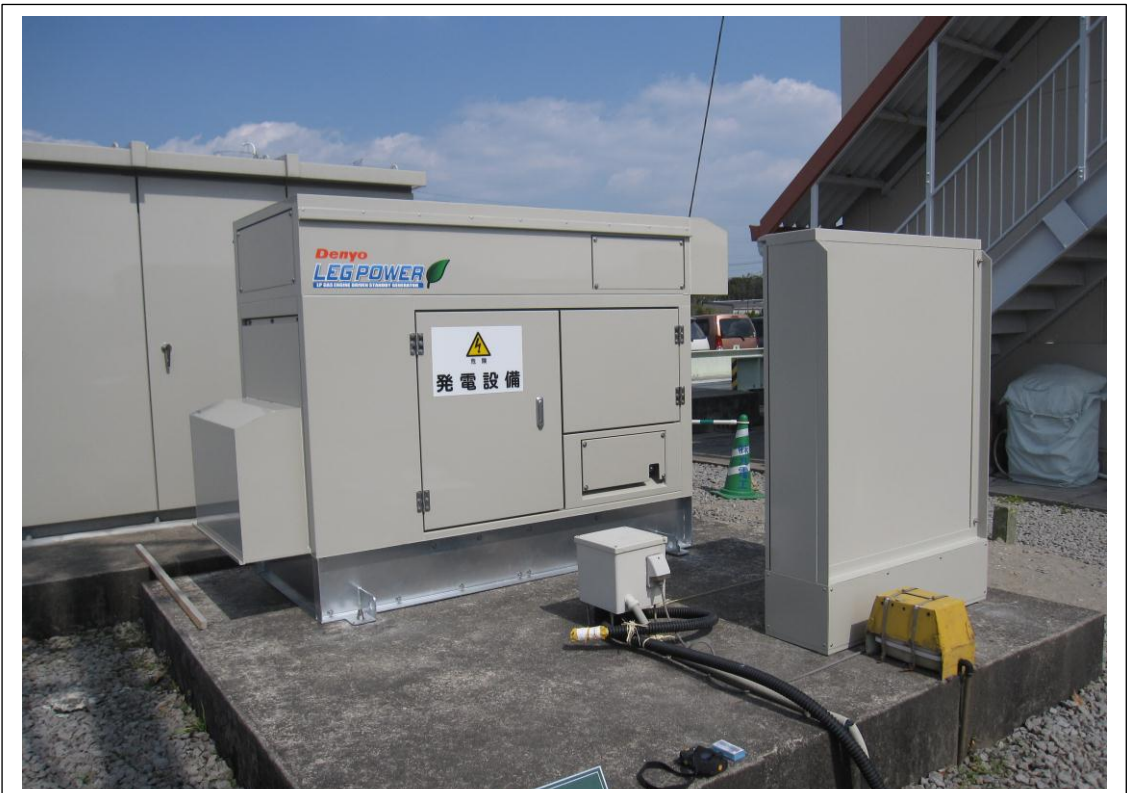
<川内ガスターミナル内 設置概況>
