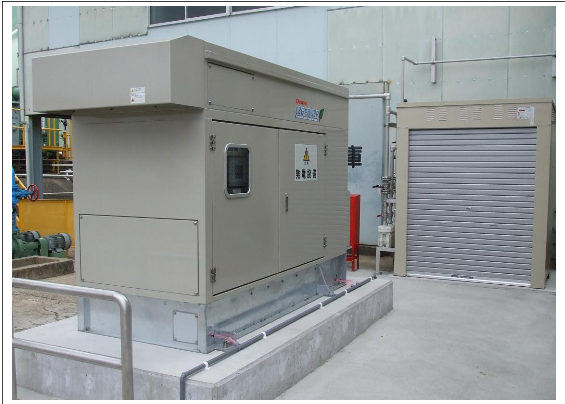
<唐津ガスターミナル内 設置概況>
